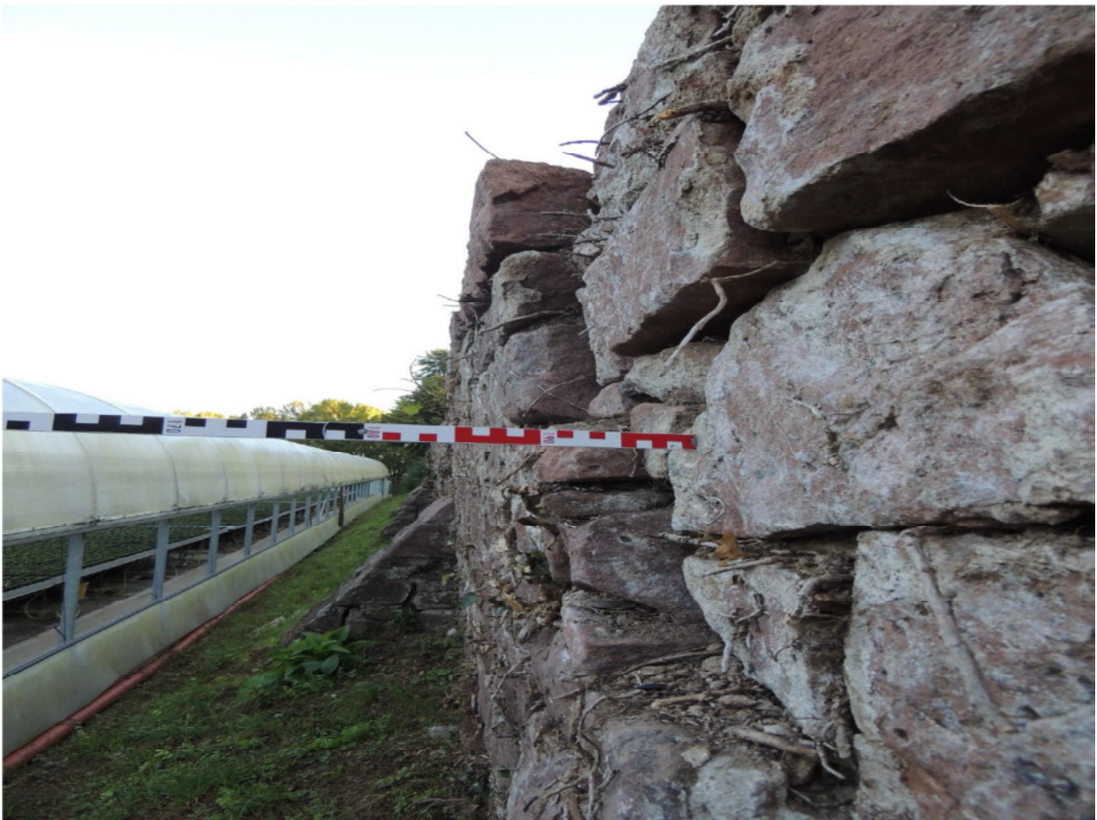
Bild 37: Mauer 2: Massive Verwerfung.
