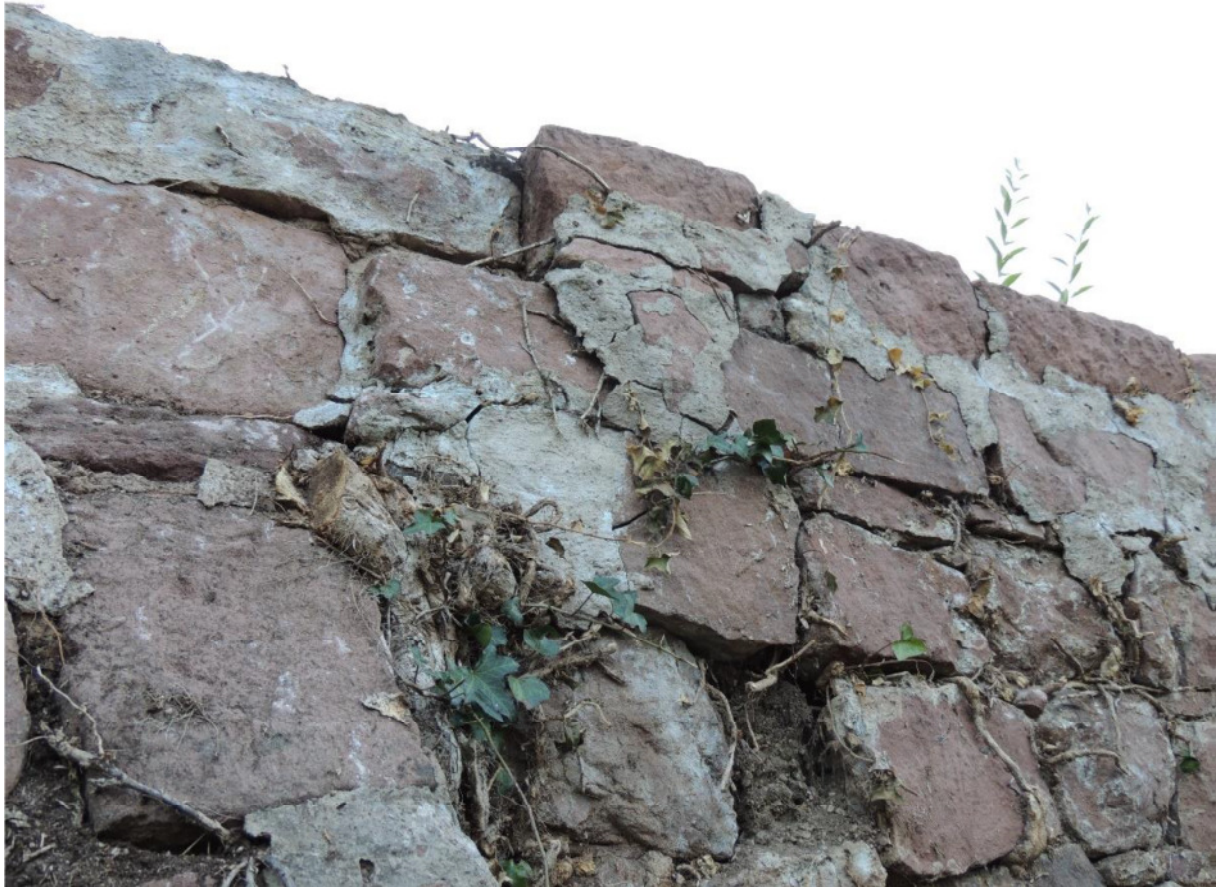
Bild 15: Mauer 2: Weit geöffnete Fugen in der Mauerabdeckung mit sichtbarem Wurzelwerk und zementären Mörtelresten aus einer früheren Maßnahme. Alle Fugen defekt.
