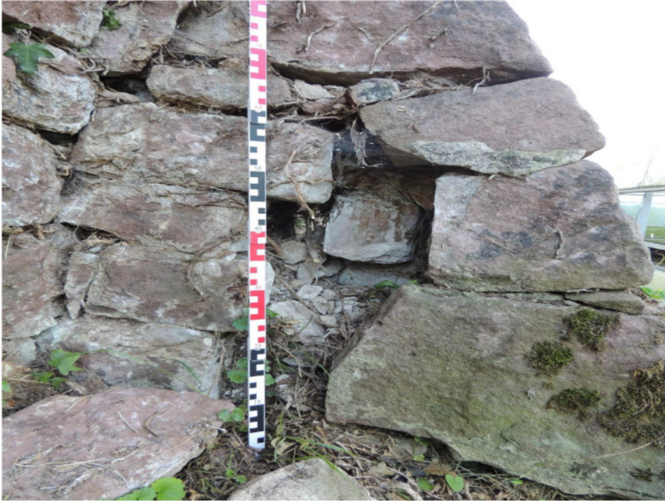
Bild 32: Mauer 2: Strebepfeiler mit sichtbarer Verformung. Fugen- und Mauermörtel kaum mehr vorhanden.
