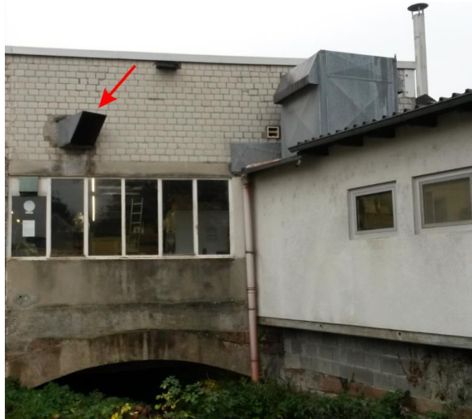
Abbildung 4-2: Ausblasung der Fortluft des Edelstahlschweißens (roter Pfeil)
