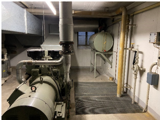
Abbildung 1: Notstromaggregat und Dieseltank
