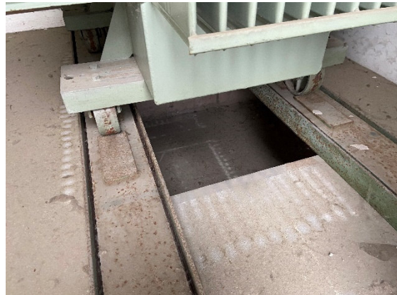
Abbildung 4: Betonwanne unter Trafo
