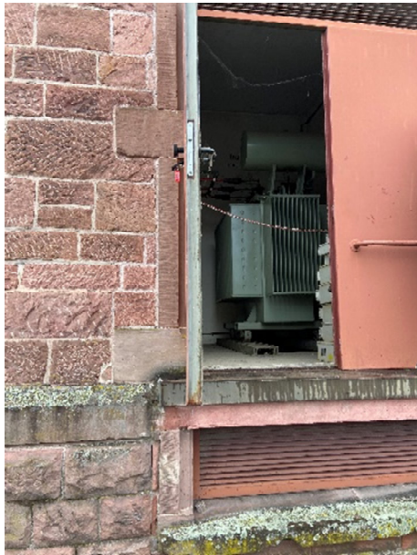
Abbildung 3: Trafo im EG mit Betonwanne, Trafo wurden PCB frei umgerüstet und zertifiziert
