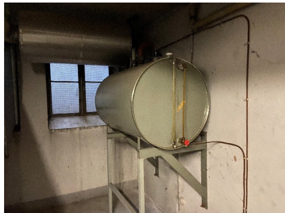
Abbildung 2: Dieseltank für Notstromaggregat
