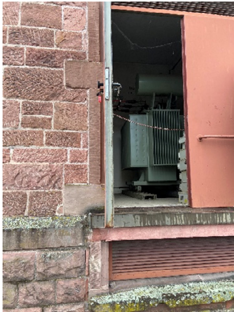
Abbildung 3: Trafo im EG mit Betonwanne, Trafo wurden PCB frei umgerüstet und zertifiziert
