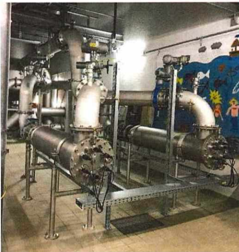
Neue UV-Desinfektion Wasserwerk
