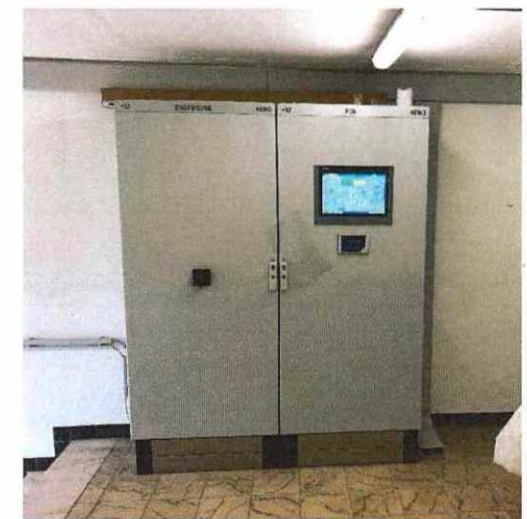
Neuer Schaltschrank HB Schutterlindenberg
