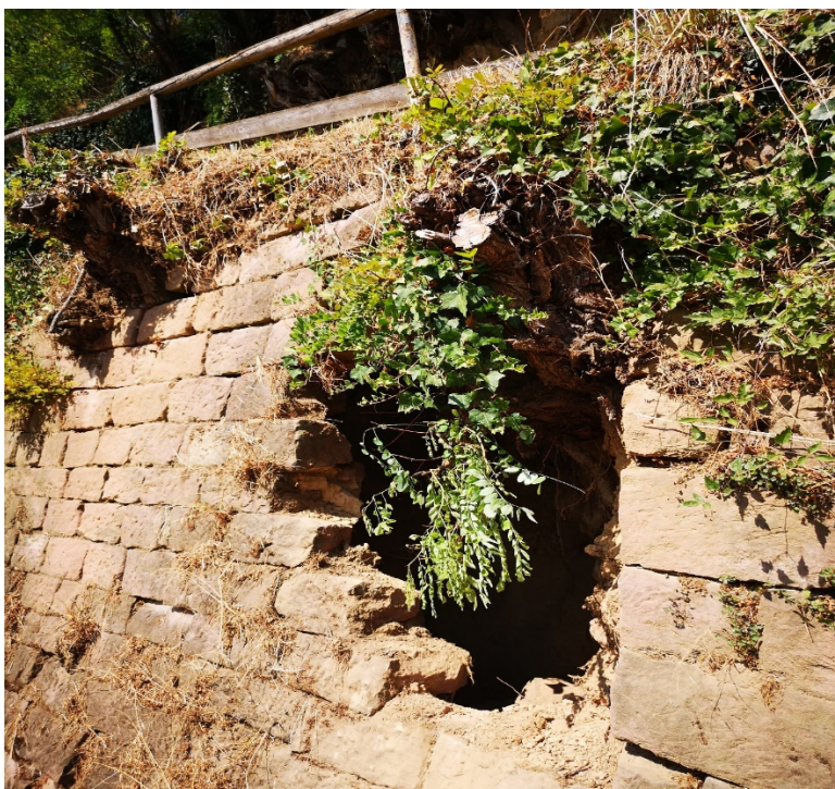
Ausbruchstelle nach Baumrückbau
