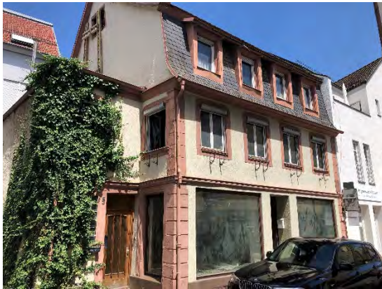
Mängel in der Bausubstanz Obststraße
