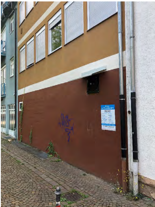
Gestaltungsmängel Fassade Roßplatz
