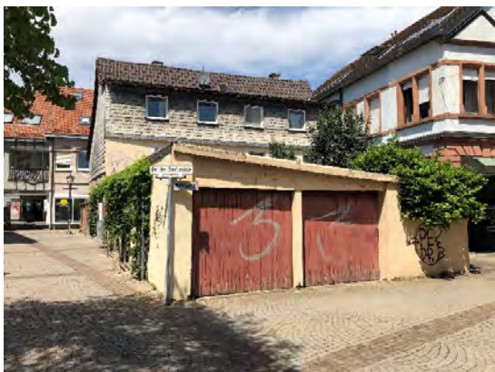
Mängel in der Bausubstanz Bei der Stadtmühle
