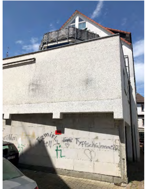
Mängel in der Bausubstanz Gasse zwischen Schloßplatz und Mühlgasse
