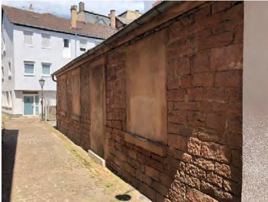
Mängel in der Bausubstanz Gasse zwischen Schloßplatz und Mühlgasse
