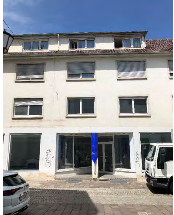
Mängel in der Bausubstanz Obststraße
