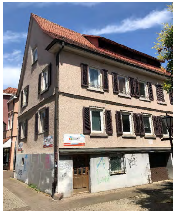
Mängel in der Bausubstanz Schloßplatz
