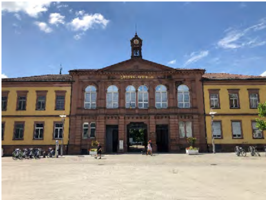
Mängel in der Bausubstanz Rathaus II – ehemalige Luisenschule
