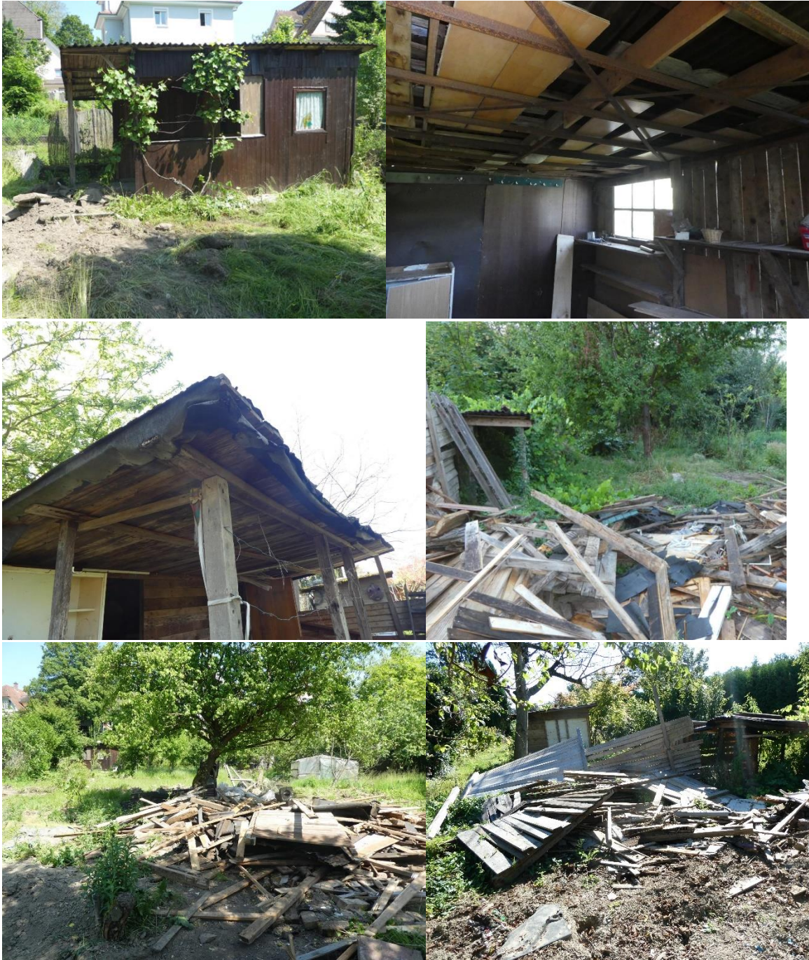
Abbildung 29: Gartenhütten im Plangebiet als potenzielle Zwischenquartiere. (teils bereits abgebrochen) Quelle: Kunz GaLaPlan 2023.
